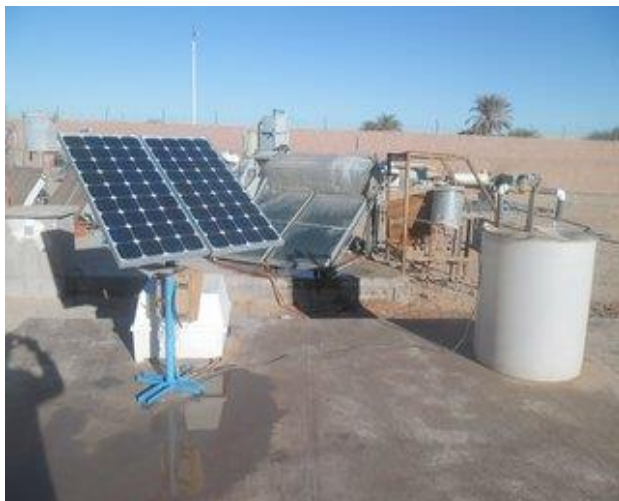
Fig.10 Application de System de pompage photovoltaïque en l'Algérie
