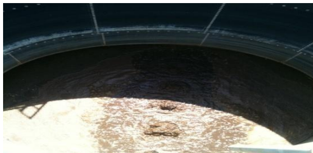
Fig.4. Sanitary water deposits Dépôt des eaux sanitaires
