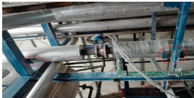
Fig. 6 Pont thermique par les supports et les appuis
