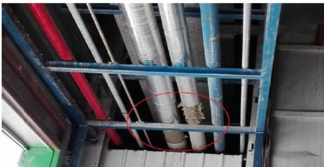
Fig. 7 Imperfection de la protection de l'isolation
